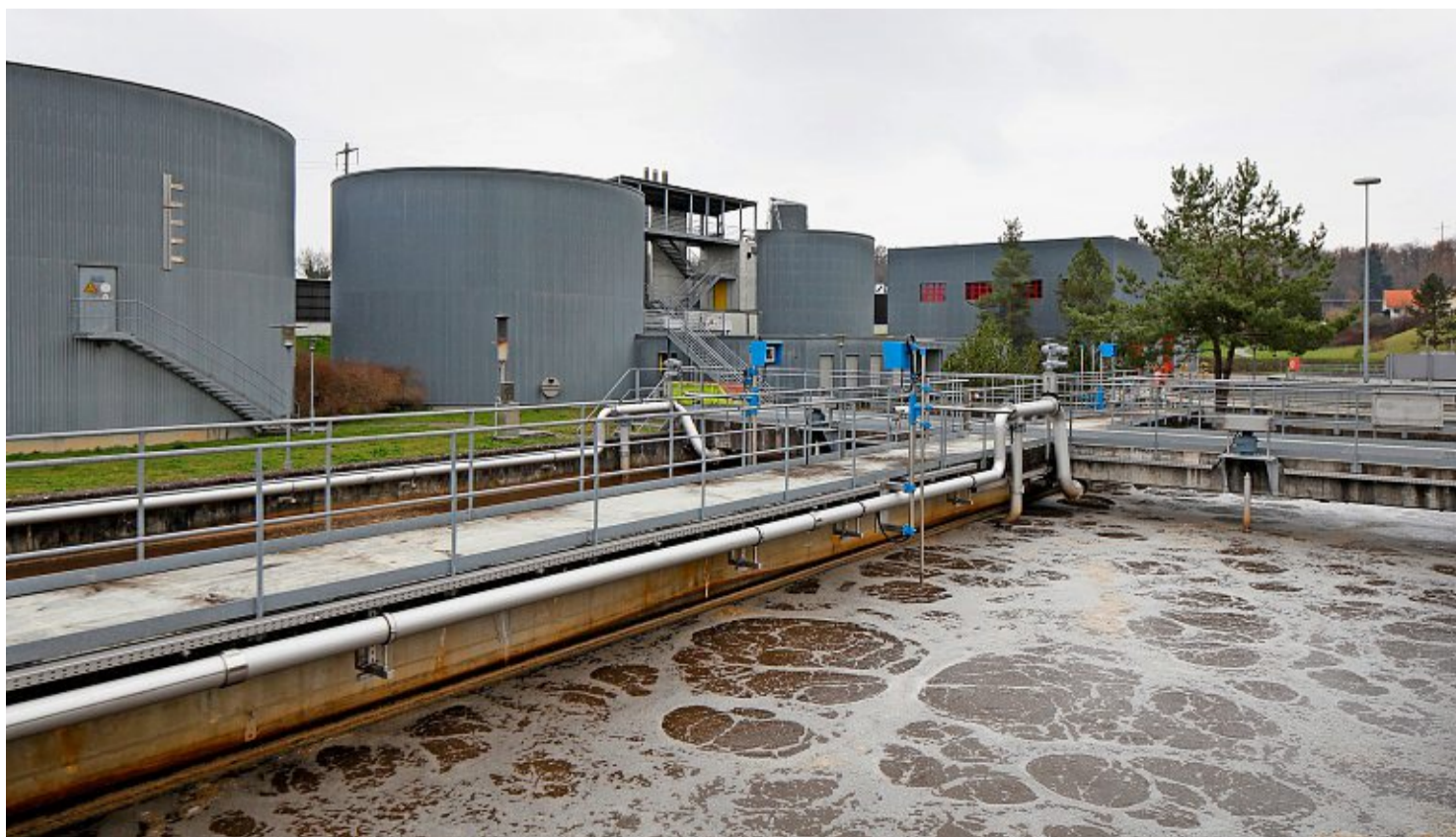
Wenn das geklärte Abwasser der ARA Furt in Bülach zurück in die Glatt fliesst, ist es immer noch etwa 10 Grad Celsius warm. Künftig können gut 200 Liegenschaften mit der Abwärme heizen. Archivfoto: Balz Murer
